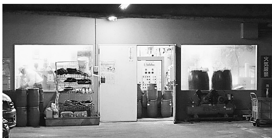
廃油リサイクル設備
